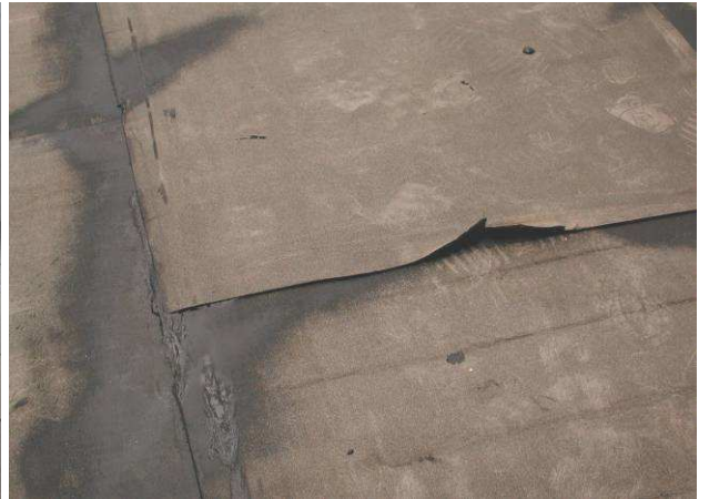
Soudures incorrectes ou insuffisantes
