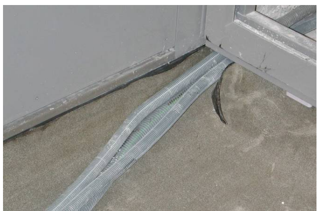
Passage de divers conduites: travail négligé / insuffisant
