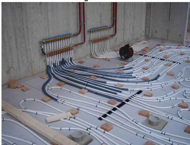
Distributeurs du chauffage au sol
