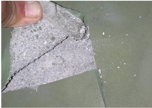
Chape en ciment : % du ciment insuffisant
