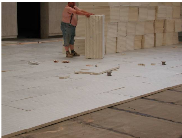
Pose de l'isolation de base, prêt pour recevoir le chauffage au sol
